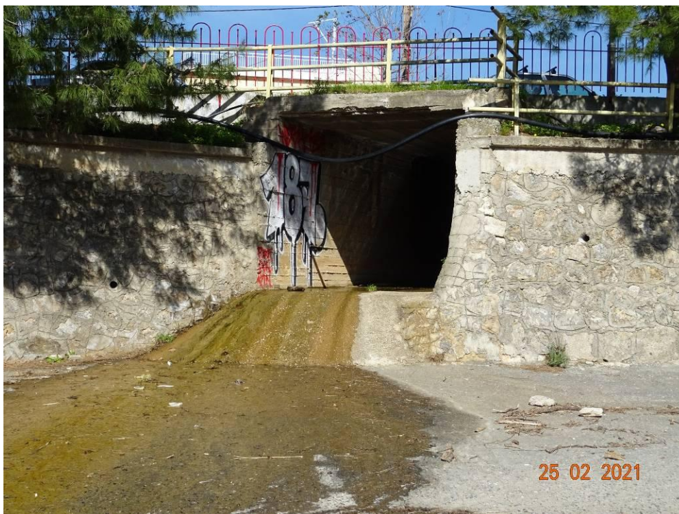
Εικόνα 14.62: Συμβολή υφιστάμενης διευθετημένης κοίτης ρ. Καραμπογιά, στον π. Νέδοντα, κάτω από την οδό Αρτέμιδος (~Χ.Θ. 2+990 προβλεπόμενου έργου αναδιευθέτησης π. Νέδοντα).
