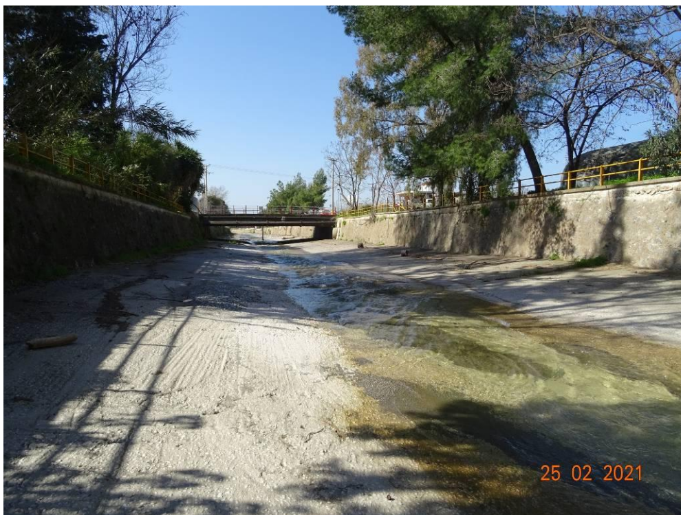
Εικόνα 14.65: Αποψη υφιστάμενης διευθετημένης κοίτης π. Νέδοντα από το πέρας των προτεινόμενων έργων αναδιευθέτησής της (~Χ.Θ. 3+200). Διακρίνεται η γέφυρα της οδού Σπάρτης. Θέα προς τα κατόντη.
