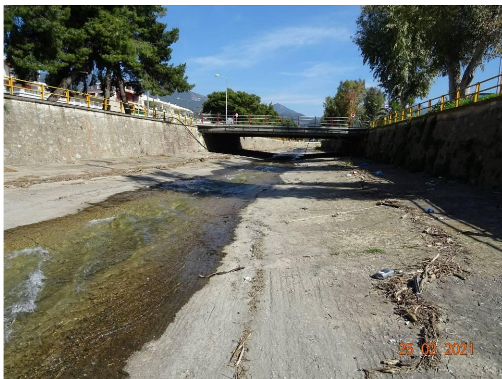
Εικόνα 14.55: Άποψη υφιστάμενης διευθετημένης κοίτης π. Νέδοντα (~Χ.Θ. 2+650). Διακρίνεται η γέφυρα της οδού Αγοράς. Θέα προς τα ανάτη.
