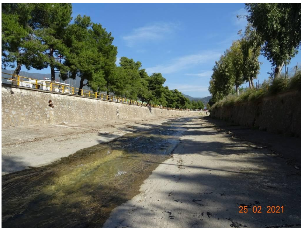
Εικόνα 14.58: Άποψη υφιστάμενης διευθετημένης κοίτης π. Νέδοντα (~Χ.Θ. 2+750). Στην εν λόγω θέση και στα αριστερά, προβλέπεται η συμβολή του έργου διευθέτησης του ρ. Καραμπογιά (Χ.Θ. 0+000). Θέα προς τα ανάντη.
