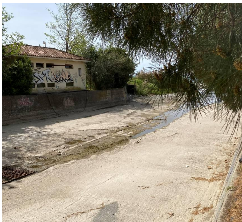
Εικόνα 14.16: Άποψη υφιστάμενης διευθετημένης κοίτης π. Νέδοντα (~Χ.Θ. 0+115). Διακρίνεται το κτίριο του αντλιοστασίου αποχέτευσης ακαθάρτων της ΔΕΥΑΚ.
